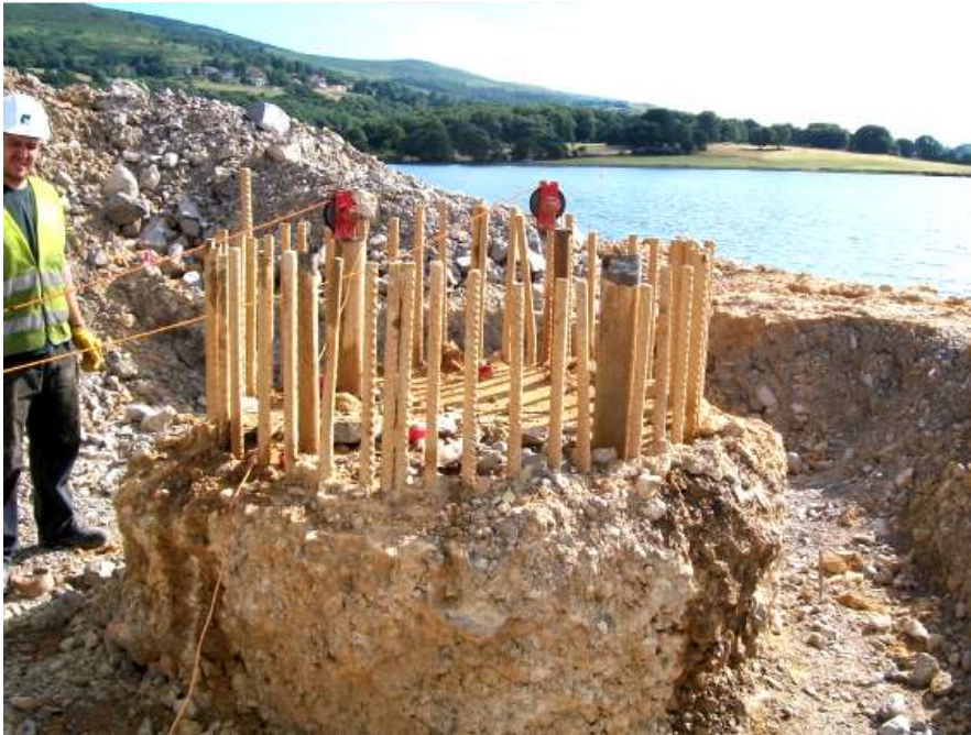
Ilustración 14. Ensayo Cross-Hole en estribo E-1 ( Orzales )
