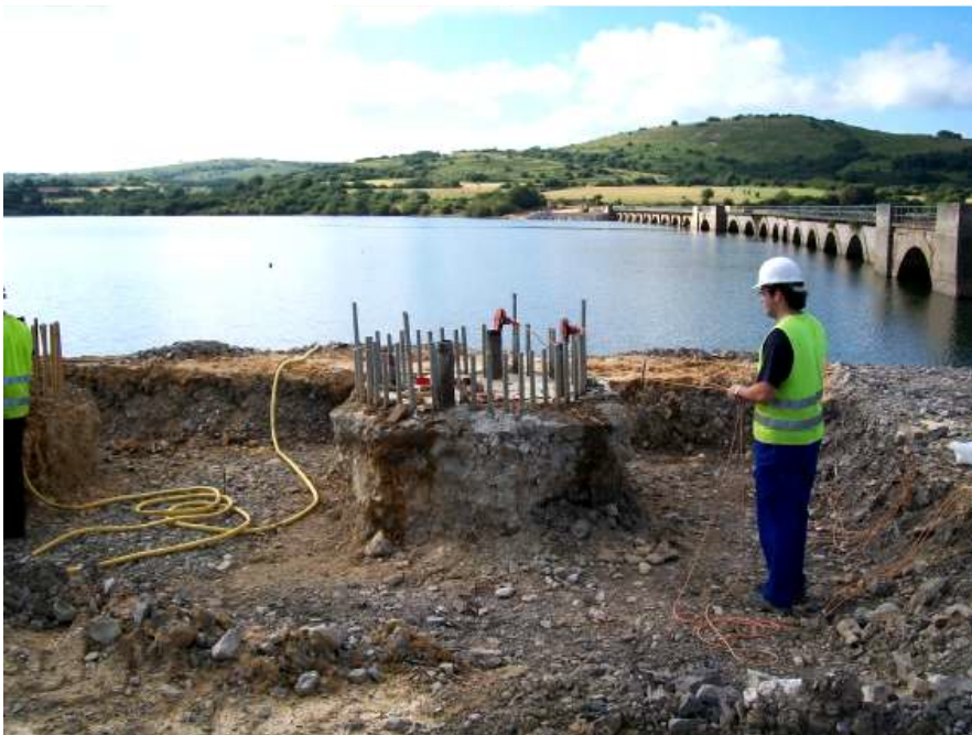
Ilustración 15. Ensayo Cross-Hole en estribo E-1 ( Orzales )
