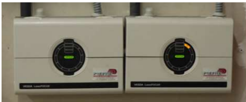
Ilustración 7- Detectores de humo por aspiración («Tipología de los detectores de incendios de incendios y gases», 2012)
