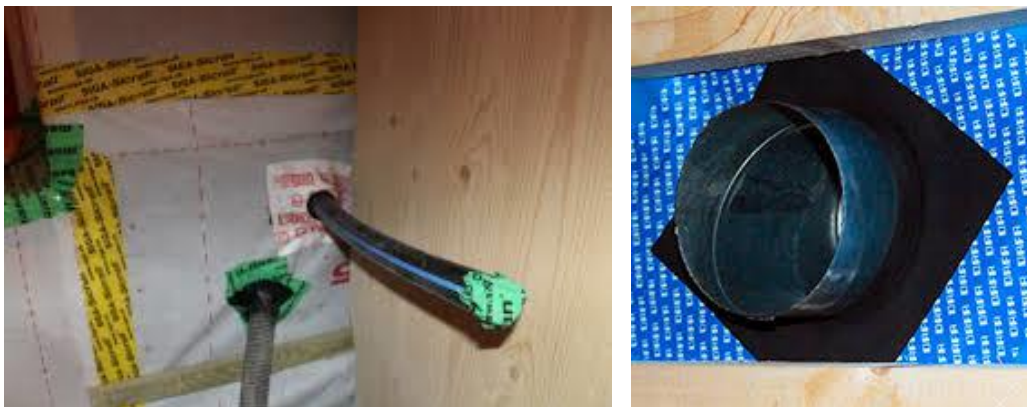
Fotografía 5 Ejemplos de estanqueidad para el paso de conductos.
