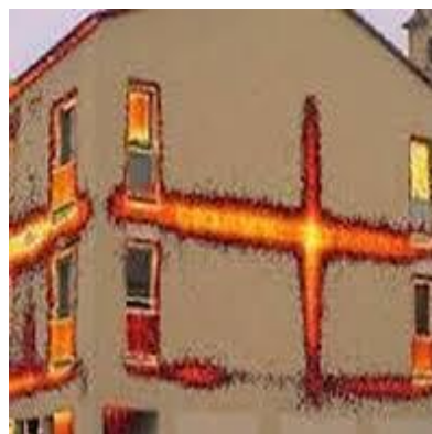
Ilustración 28 Termografía de puentes térmicos
