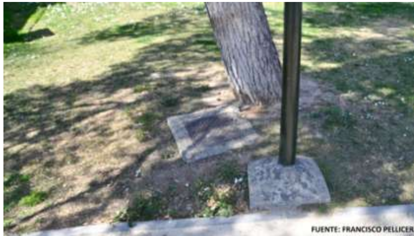
Ilustración 69 (Registro eléctrico junto a un pino en el Parque Bruil).
