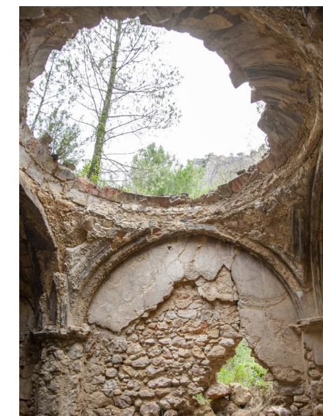
Fig 3.93 Estado actual de la capilla anexa a la fábrica
