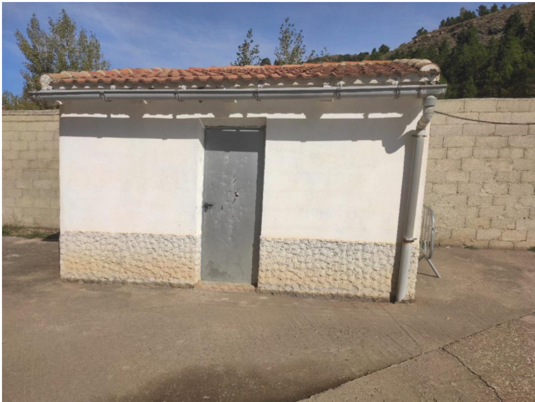
Caseta material. EA_Nivel 3.
