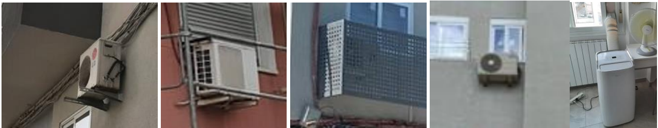
Figura 12. Sistemas de refrigeración viviendas 1º1ª, 2º1ª, 2º2ª, 4º1ª y 5º3ª,
