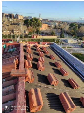
Figura 4. sustitución de teja y colocación de capas de impermeabilización y de aislamiento térmico y
