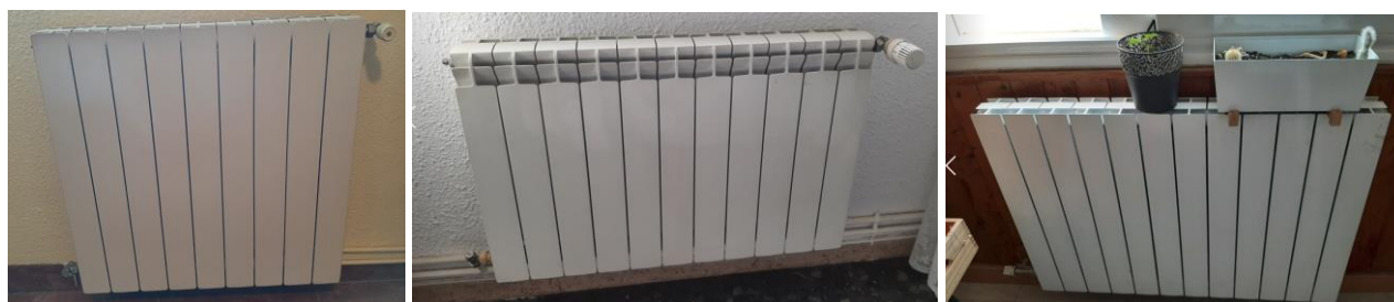
Figura 10. Radiadores en viviendas de muestra 1º-1ª, 3º-3ª y 5º-3ª
