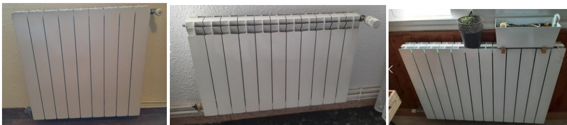
Figura 8. Radiadores en viviendas de muestra 1ª-1ª, 3ª-3ª y 5ª-3ª
